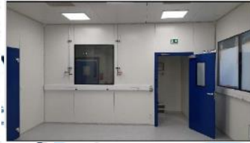
Salle blanche bâtiment 200
